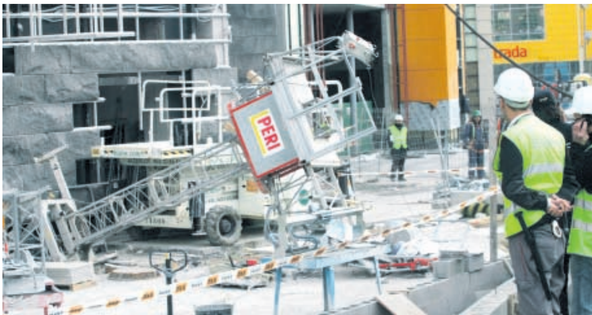
Los operarios trabajaban en la fachada de uno de los edificios del complejo cuando se desplomó el andamio, en la imagen. MARÍA AURTENECHA
